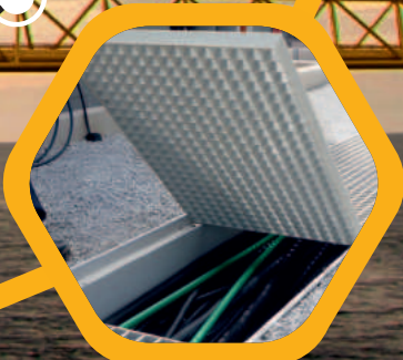
Cable Trays Kablo Kanalları
