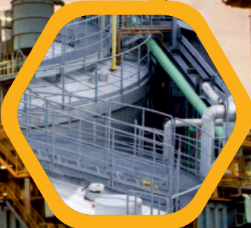
Cooling Towers Soğutma Kuleleri
